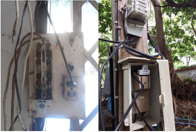
มาตรฐานระบบไฟฟ้า จุดเสี่ยง
